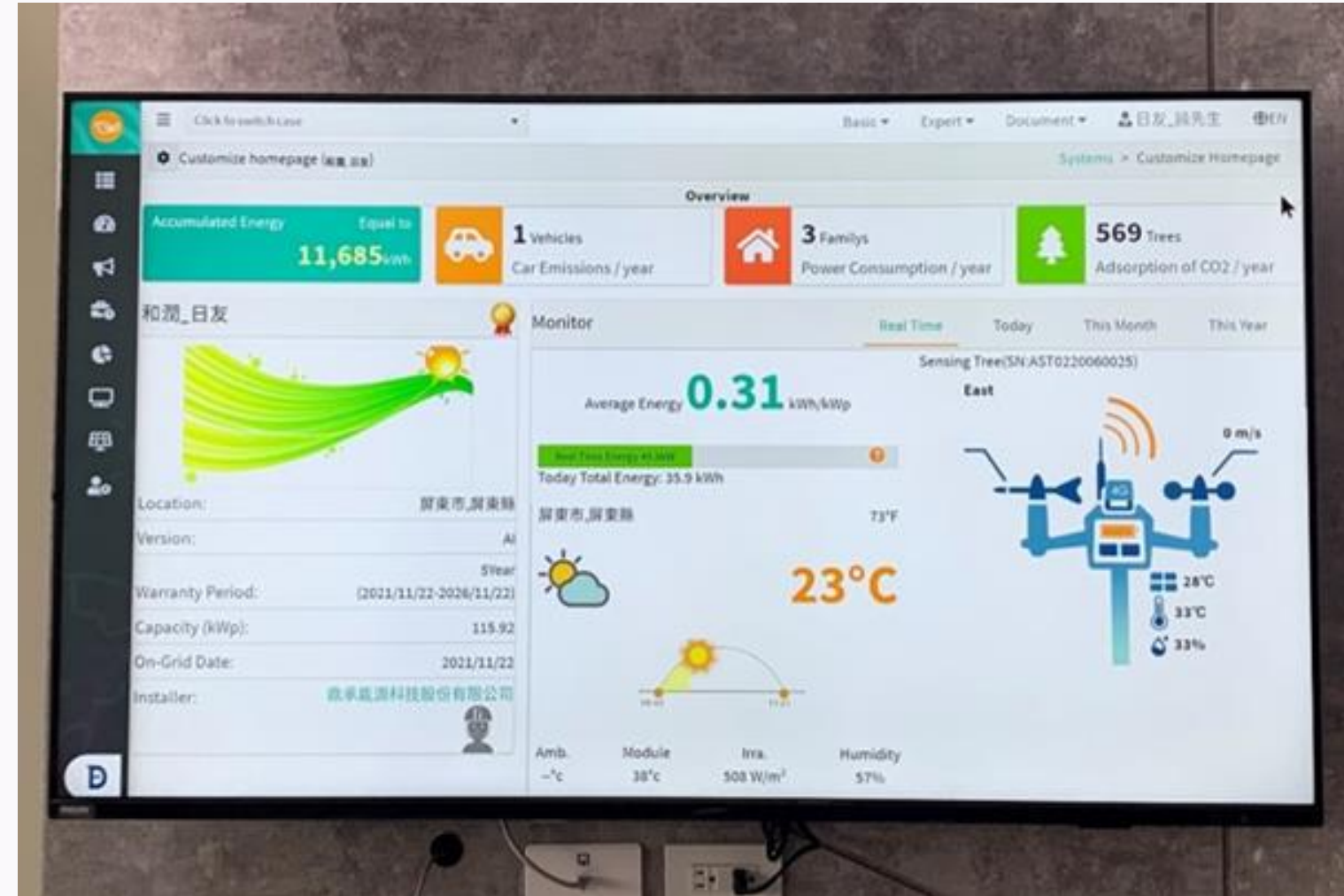
太陽光發電監視
