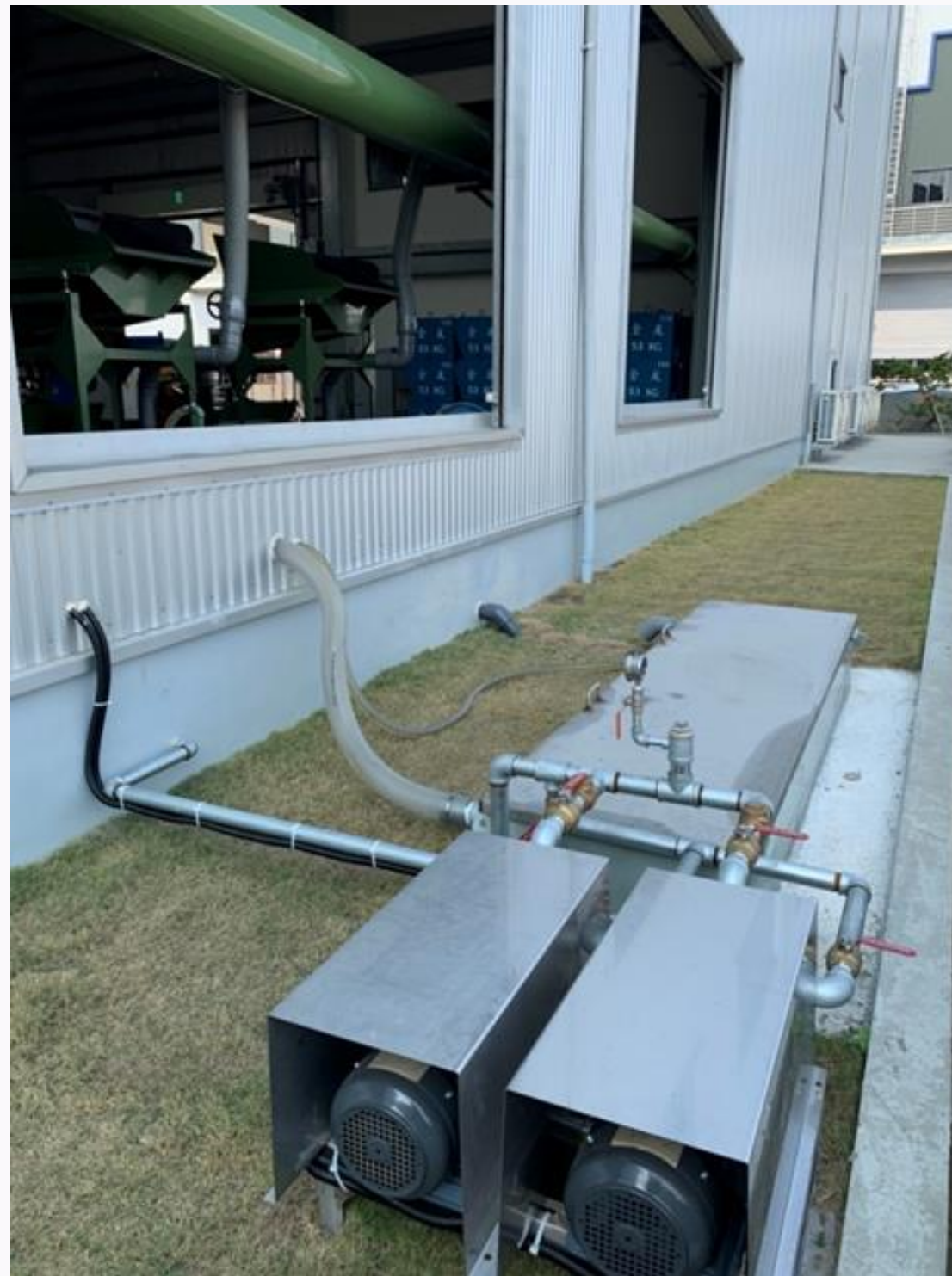
オイルサイクル設備
